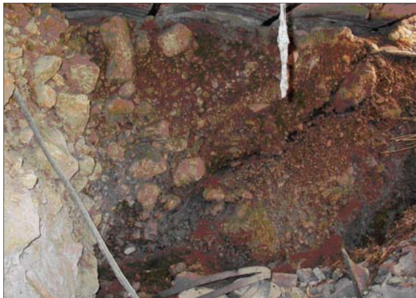
Fig. 6.11 → Il centro storico di Casentino, diffusamente e intensamente danneggiato nel corso della recente crisi sismica, è stato edificato in gran parte su ghiaie calcaree, eterometriche, addensate, in matrice limoso sabbiosa pedogenizzata, con grado di cementazione variabile. In diversi affioramenti questi depositi immergono contro monte, a causa dell'intensa attività tettonica dell'area.
