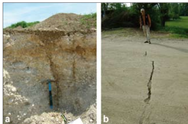
Fig. 5.3 → a) Fratture beanti sub-verticali a direzione N120° interessanti le ghiaie del Conoide di Paganica; b) Probabili fratture cosismiche a direzione N120° rilevate a Sud di Onna.
